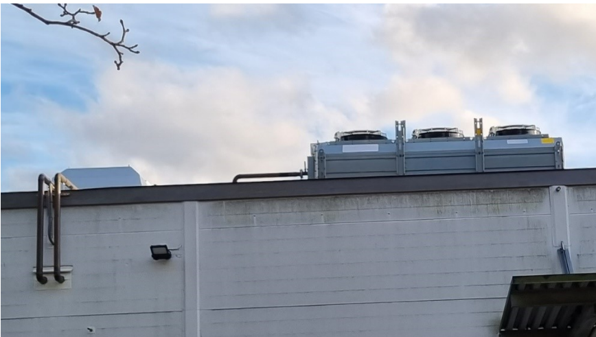
FIGUR 6: FRÅNLUFTSUTBLÅS TILL VÄNSTER OCH KYLMEDELSKYLARE TILL HÖGER.
