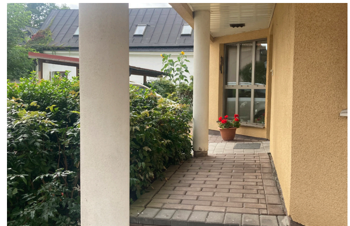
Indraget fasadparti med entré på Systrarnas hus. Det indragna fasadpartiet bärs av pelare liksom det anslutande skärmtaket. In- till entrén finns ett glasparti med karmar och bågar i guldfärgad aluminium.
