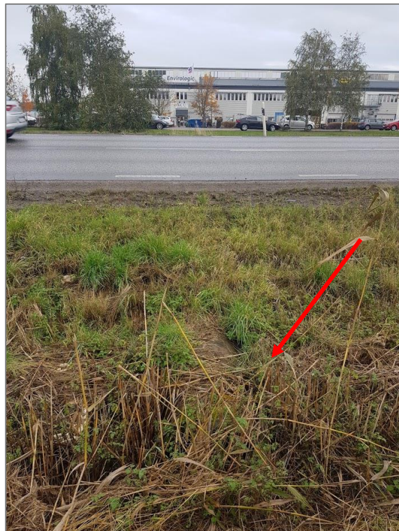
Foto 6. Kulvert i nordöst som leder dagvatten under Börjegatan. Kulverten markerad med röd pil.
