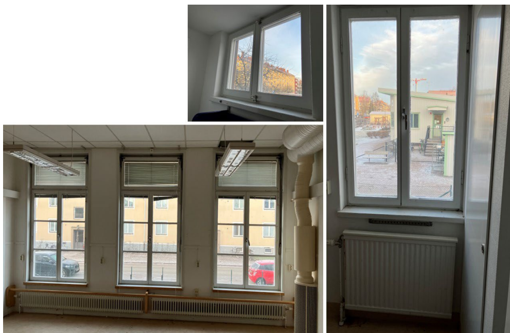
Figur 23 Foton visar fönster som exempel på karakteristiska ursprungliga fönster som skyddas med bestämmelse q4. Källa: Uppsala kommun.
