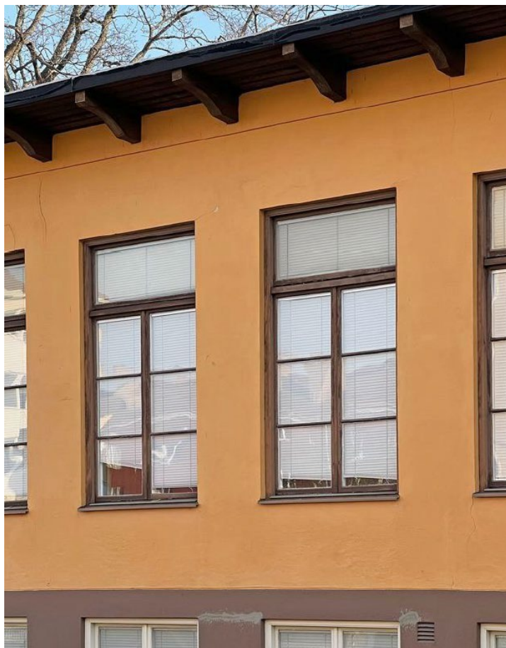
Figur 22 foton visar ursprungliga snickerierna såsom fönster och sparrarna vid takfoten samt en del av fasaden murad med lättbetong som putsats och målats i en ockragul kulör. De skyddas med planbestämmelsen k2 och q4. Källa: antikvarisk konsekvensbedömning, Hille hus o Historia AB.
