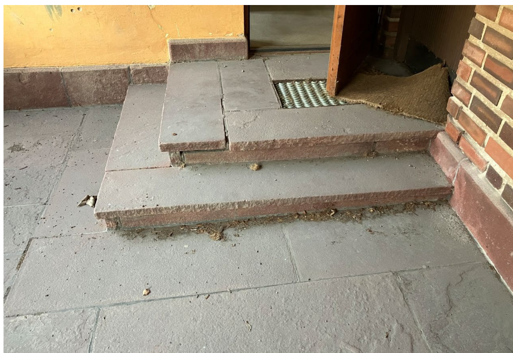
Figur 21 foton visar loggians golvbeläggning av röd kalksten samt tegelvägg som ska bevaras. Det säkerställs med skyddsbestämmelse q1. Källa: Hille hus o Historia AB.
