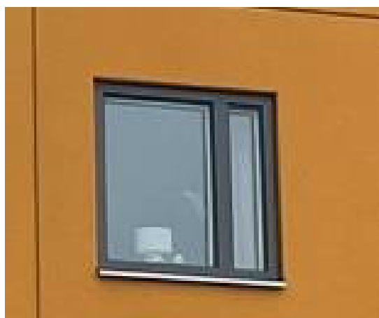
Figur 4 Närbild på ett av fönstren
