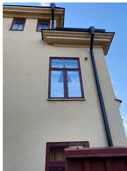
Figur 5 Närbild på ett av fönstren
