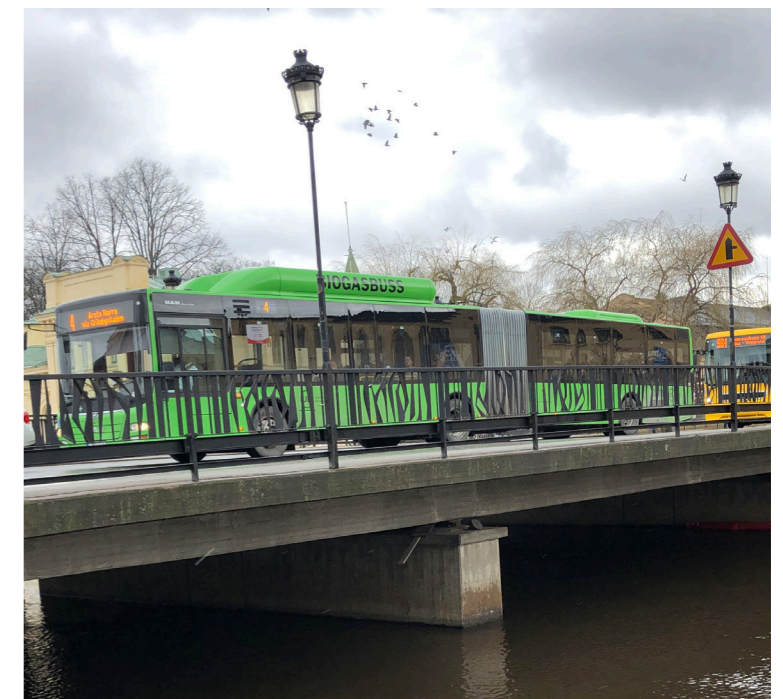
Nedböjning/deformation över mittstödet.
