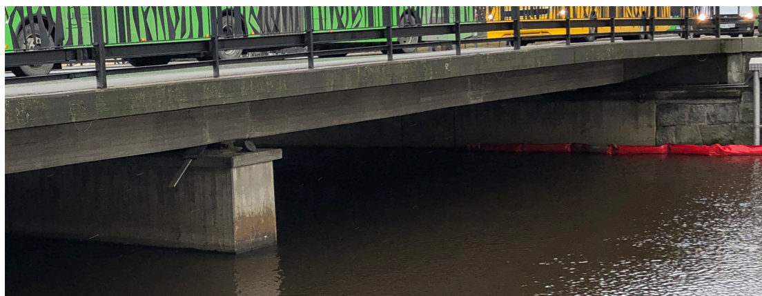
Bilden visar bronns nedböjning vid mellanstödet.
