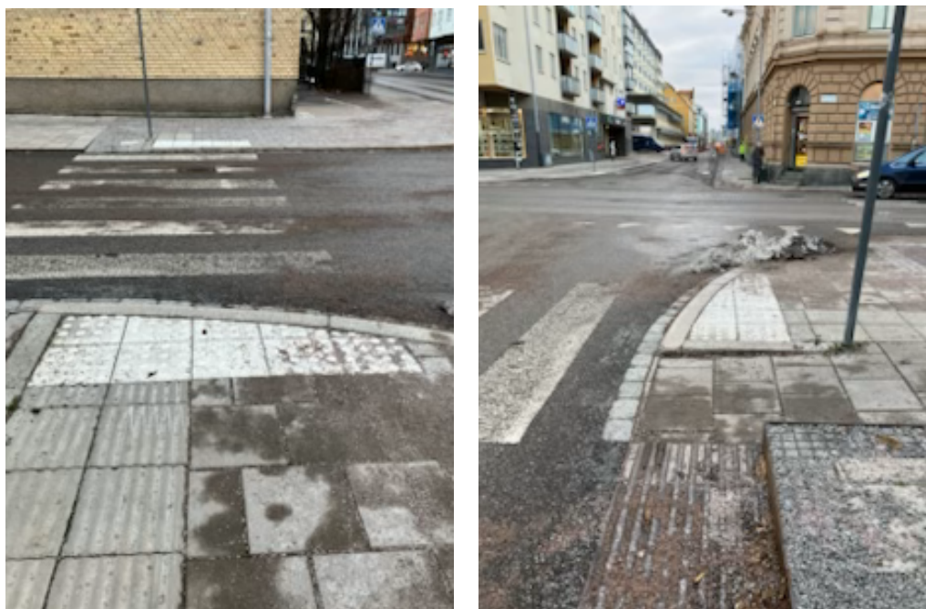
Bild 1–2. Foton från Bäckens gränd som visar hur ledplattor använts i situationer där en kantsten som ligger vinkelrät mot gatan inte varit möjlig.
