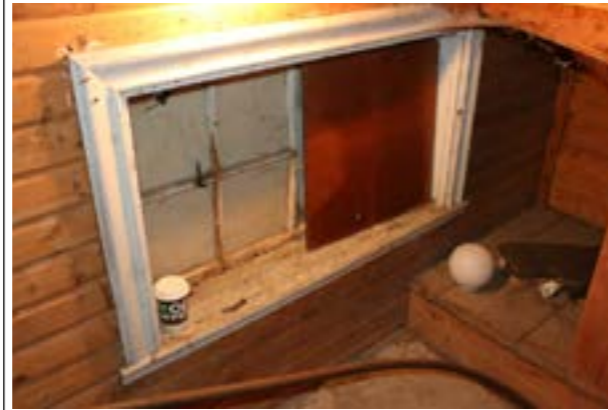
Fönster i verandans grund är täckt exteriört. Interiör småspröjsat fönster med ursprungligt foder.
