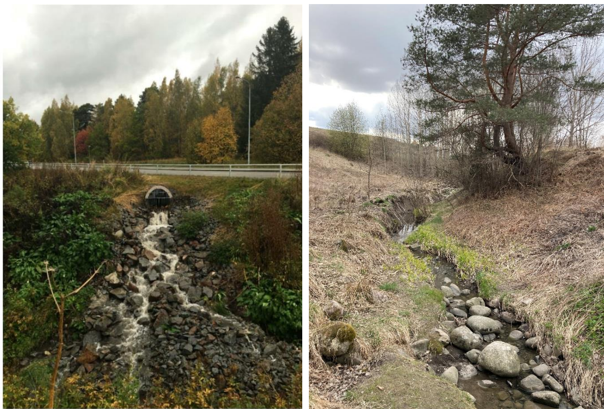
Figur 8. Till vänster. Utlopp via ledning under Gottsunda allé, RU2. Foto: Bjerking (2018). Till höger: Ravinen fotad västerut mot utlopp RU1. Foto: WSP (2021).
