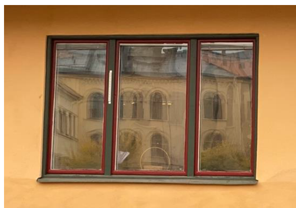
Figur 3 Närbild på ett av fönstren
