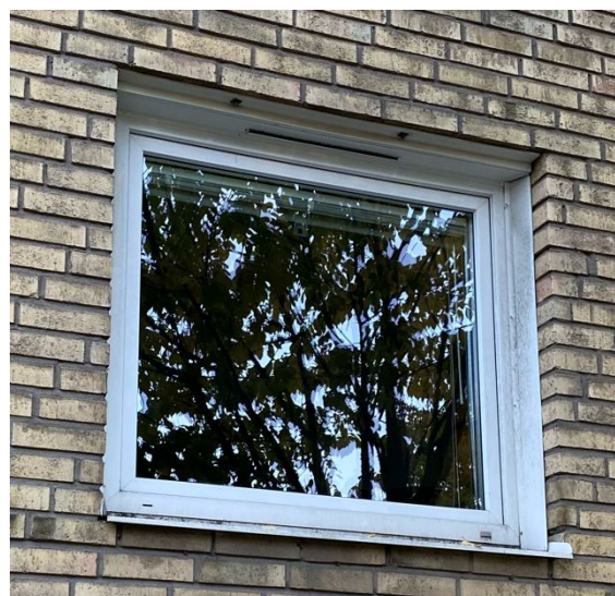
Figur 3 Närbild på ett av fönstren
