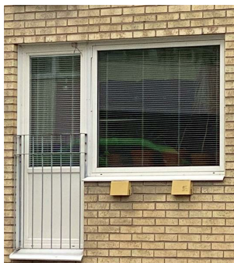
Figur 4 Närbild på ett av fönstren
