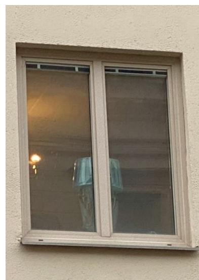
Figur 5 Närbild på ett av fönstren
