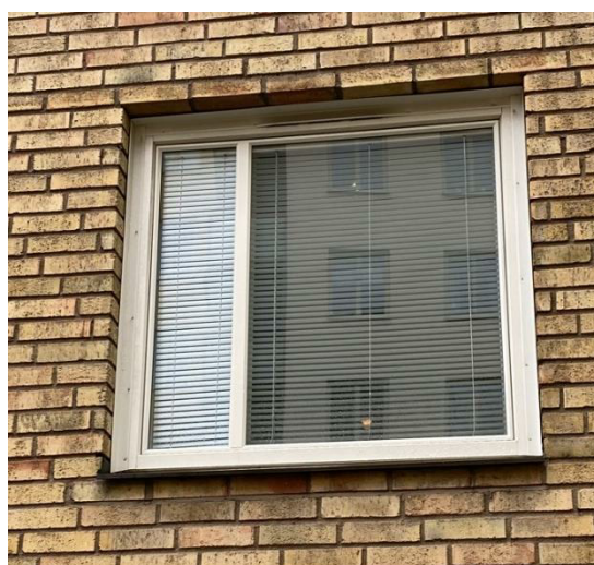
Figur 5 Närbild på ett av fönstren
