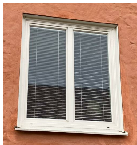
Figur 5 Närbild på ett av fönstren
