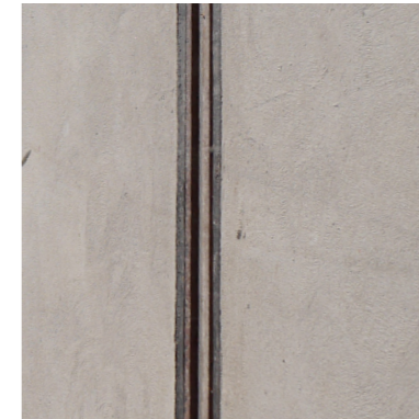
Figur 9. Betong i spår.
