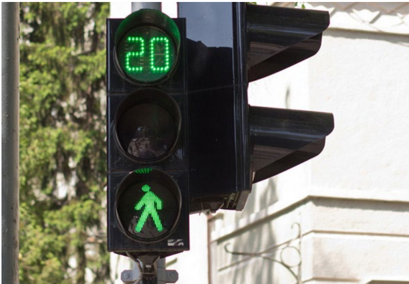
Bild 4, tidsstyrt övergångsställe, grön signal
