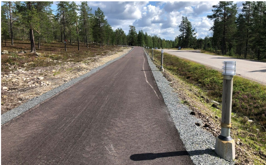
Figur 27 Exempel på hur de låga belysningsstolparna kan utformas längs gång- och cykelvägen. Referensbild från Idre.
