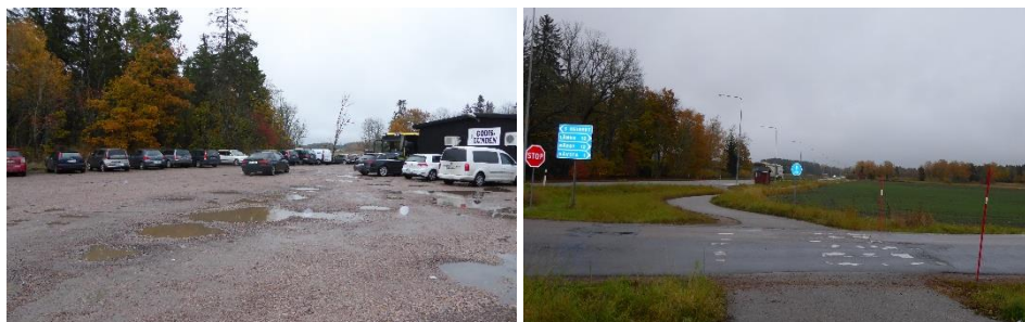
Figur 18. Parkeringen vid Godislunden i Rasbo. Groparna är vattenfyllda och övergångsstället är dåligt markerat. Foto: WSP 2019.
