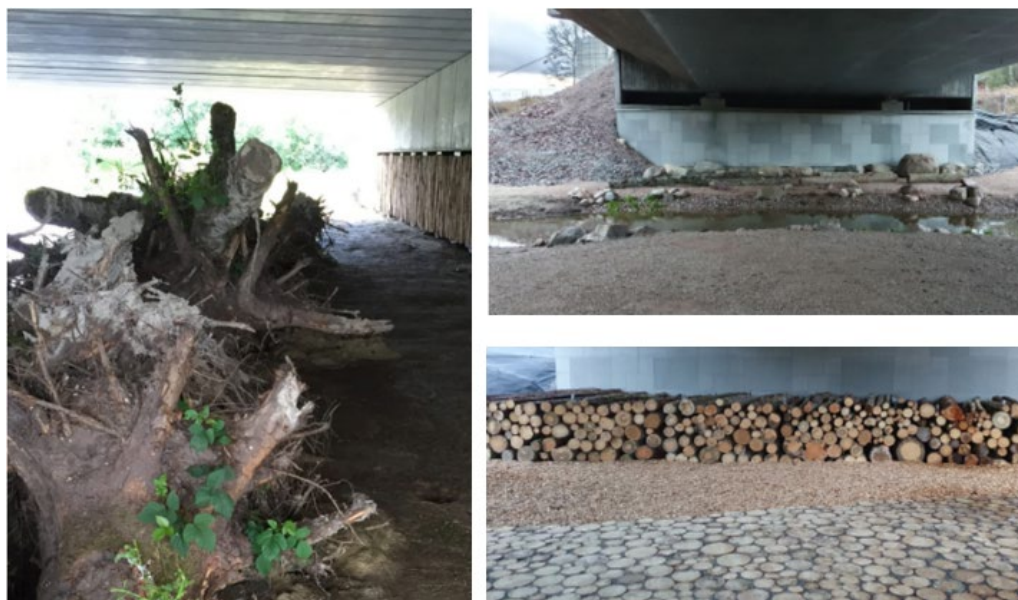
Figur 73: Exempel på hur marken under bron kan användas för att möjliggöra bon eller skydd för insekter och mindre djur. Rotklumpar, stenhögar eller stockar kan läggas upp. Bild: Bjerking.
